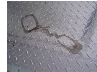
Al och gulmetall missfärgning
